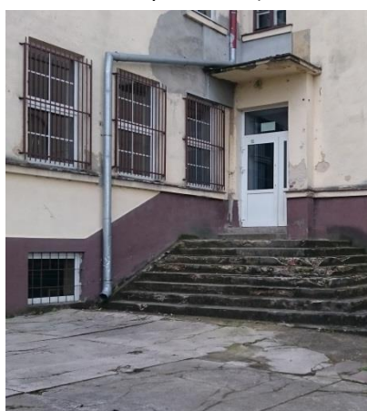
Budynek zespołu szkół – stan wejścia bocznego stanowi niebezpieczeństwo dla zdrowia dzieci
